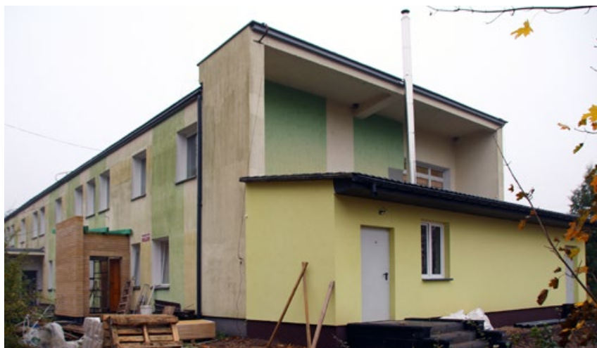
Przedszkole Samorządowe w Gródku z nową kotłownią
